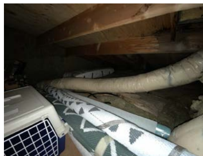
Stedvis misfarget undertak.
