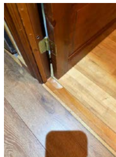
Bildet viser slitasje på dørterskel.
