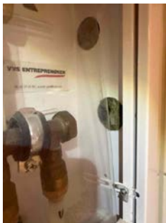
Bildet viser rørskapet med utette gjennomføringer.
