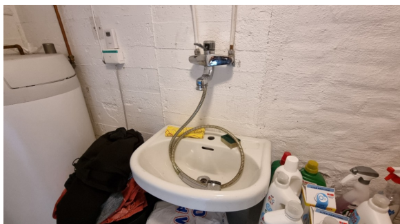
Enkelt opplegg med servant og veggmontert blandebatteri.
