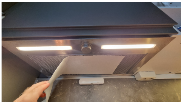
Funksjonstesting av det mekaniske avtrekket over koketoppen.
