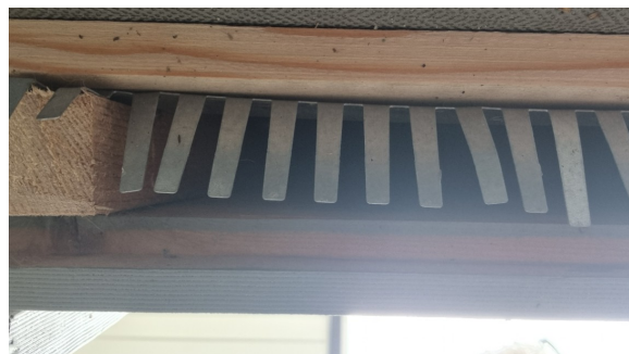
Synlig musebånd i underkant av kledningen
