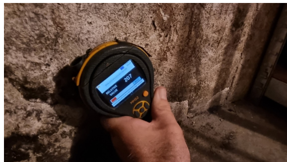
Fuktmåling i vegger, noe forhøyede fuktverdier ble registrert.
