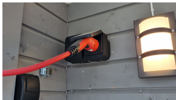
El-billader montert like utenfor inngangsdøren.
