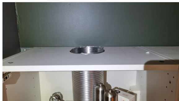
Ventilasjonskanal blir ikke ledet ut.
