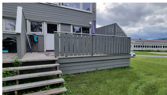
Trapp til terrassen mangler rekkverk/gelender.
