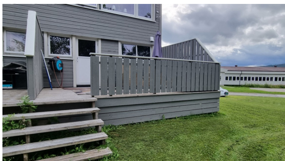
Rekkverket tilfredsstillende ikke dagens krav til høyde.
