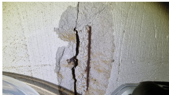
Sprekker i grunnmur/kjelleryttervegger i kjelleretasjen.
