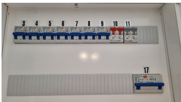
Kontroll av el-skapet.
