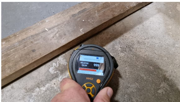
Fuktmåling i gulvet, forhøyede fuktverdier ble registrert
