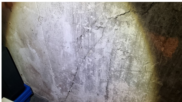
Sprekker i grunnmur/kjelleryttervegger i kjelleretasjen.
