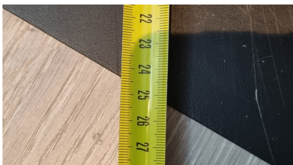
Platen foran vedovnen er noe for kort ved den ene siden i forhold til dagens krav (30 cm).
