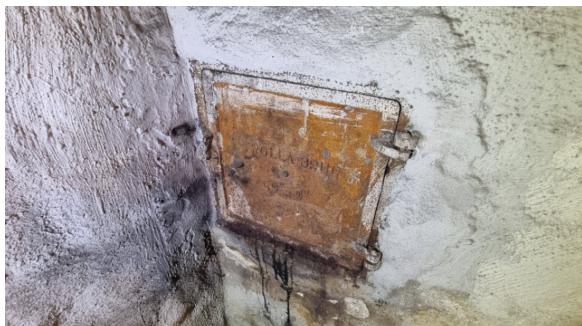
Kontroll av sotluke. Rust i luken.
