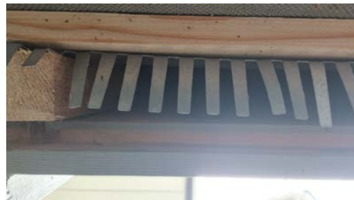
Synlig musebånd i underkant av kledningen
