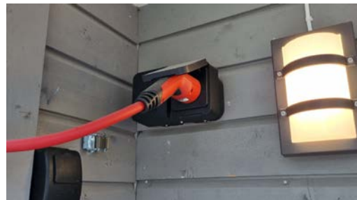
El-billader montert like utenfor inngangsdøren.
