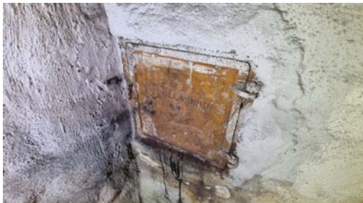
Kontroll av sotleuke. Rust i luken.
