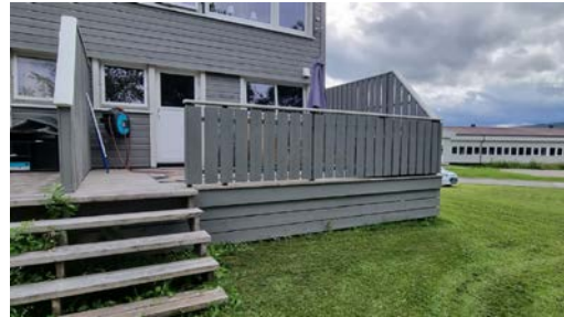
Trapp til terrassen mangler rekkverk/gelender.
