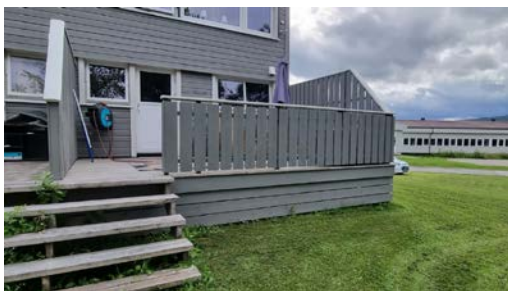
Rekkverket tilfredsstillende ikke dagens krav til høyde.
