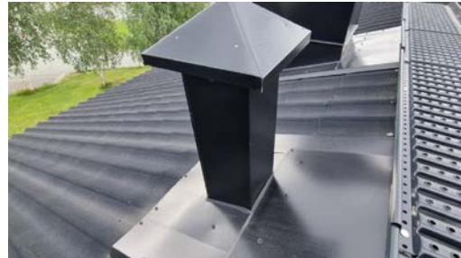
Kontroll av luftehatt
