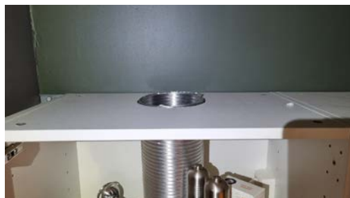
Ventilasjonskanal blir ikke ledet ut.
