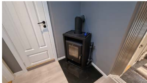
Vedovn i trappegang.
