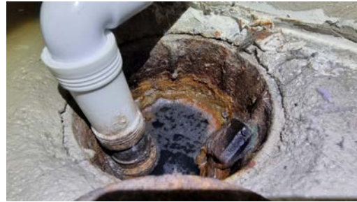
Soilsluk fra byggeår.
