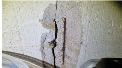
Sprekker i grunnmur/kjelleryttervegger i kjelleretasjen.
