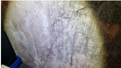
Sprekker i grunnmur/kjelleryttervegger i kjelleretasjen.
