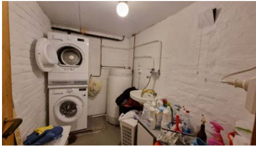
Vaskerom i kjeller.
