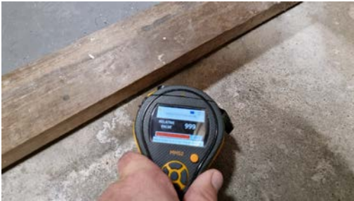
Fuktmåling i gulvet, forhøyede fuktverdier ble registrert
