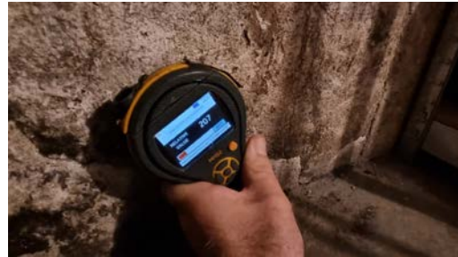
Fuktmåling i vegger, noe forhøyede fuktverdier ble registrert.
