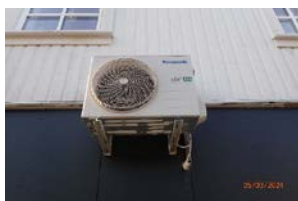
Utedel for luft til luft varmepumpe i næringsdel.
