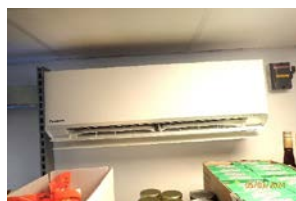
Innedel for luft til luft varmepumpe i næringsdel.
