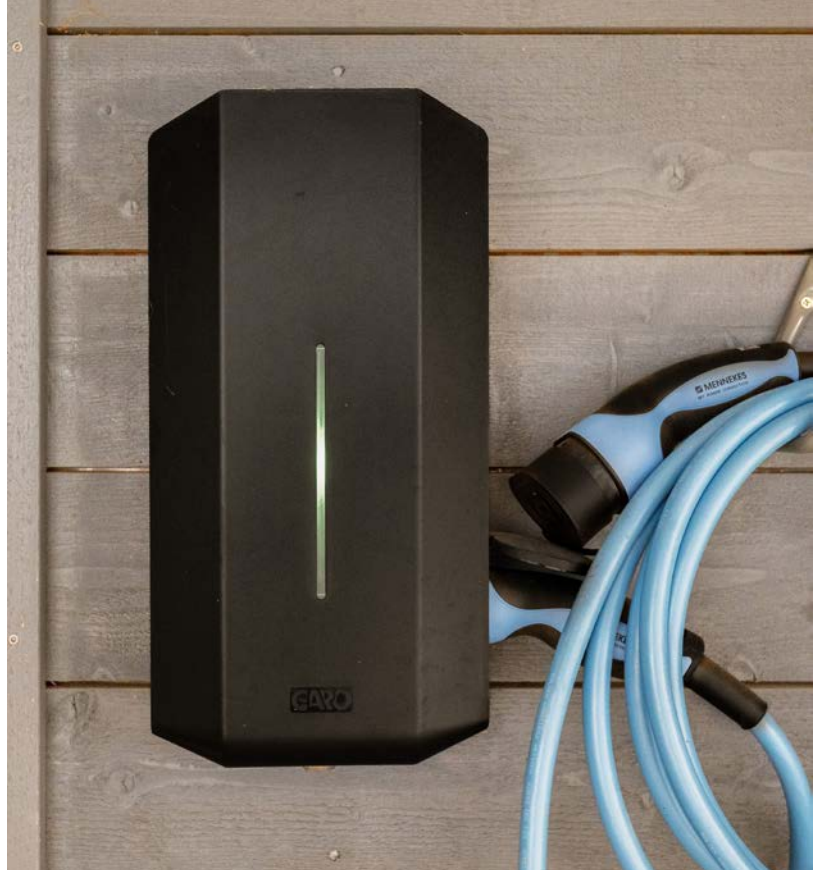
Det er montert elbil-lader.
