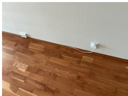
Ufagmessig opplegg med stikkontakter koblet med lampettledning.
