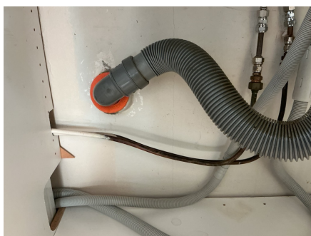
Leiligheten har synlig avløpsrør i plast og støpejern.
