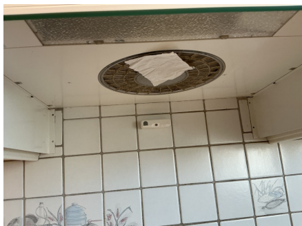
Avtrekkseffekten er testet med papir.
