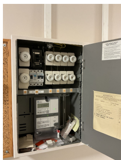
Sikringskap er plassert i felles trappegang.
