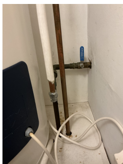
Hovedstoppekran er plassert i kasse på toalettrom.
