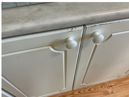
Kjøkkeninnredningen er slitt med enkelte skader.
