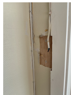
Avklipt ledning ved balkongdør.
