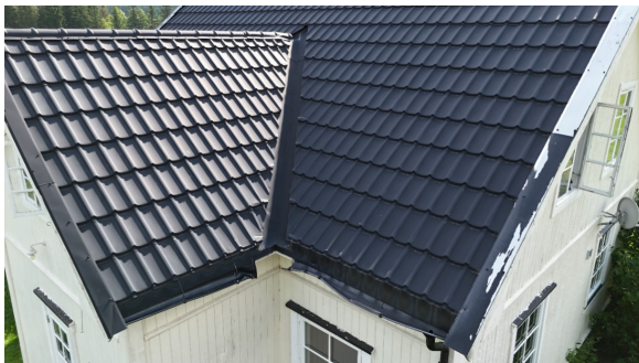
Skader i takrenner.
