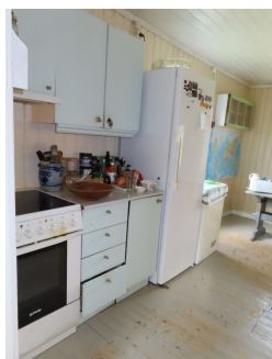
Kjøkken fremstår med naturlige renoveringsbehov jfr. alder.
