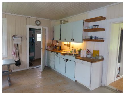
Kjøkken fremstår med naturlige renoveringsbehov jfr. alder.
