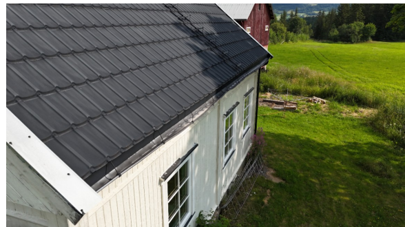
Skader/nedbøyninger i takrenner.
