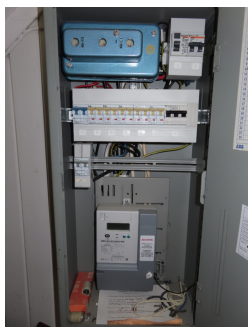
Sikringsskap med skrusikringer og automater.
