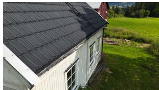
Skader/nedbøyninger i takrenner.
