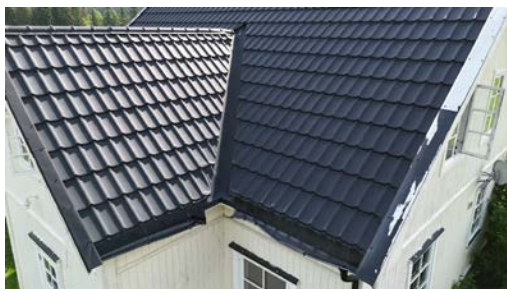
Skader i takrenner.
