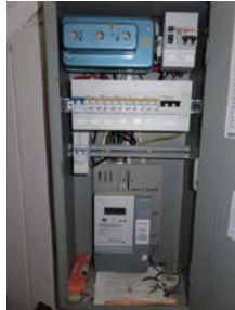
Sikringsskap med skrusikringer og automater.
