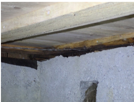
Det er råte i konstruksjonen over innvendig hjørne.
