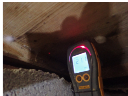
Det måles høyt innhold av fukt med skadepotensiale på kontrollert sted i etasjeskille.
