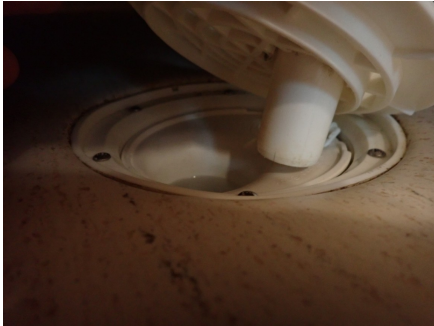
Sluk under dusjkabinett.
