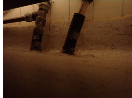
Det er ingen tettemansjett / liten oppkant på gulvbelegget rundt rørgjennomføringer i gulvet.
