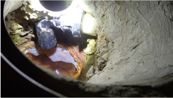
Soilsluk fra byggeår.
