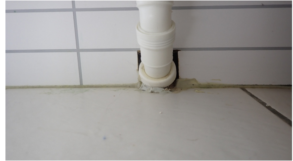
Utettheter ved rørgjennomføringer i vegg ved dusjkabinett.
