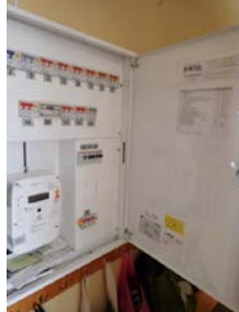
Sikringskap med automatsikringer fra 2005.
