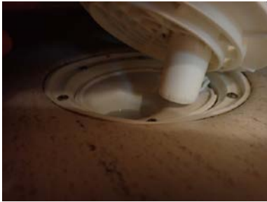
Sluk under dusjkabinett.
