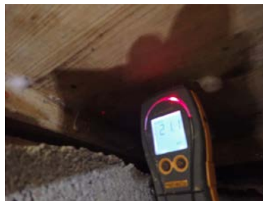
Det måles høyt innhold av fukt med skadepotensiale på kontrollert sted i etasjeskille.
