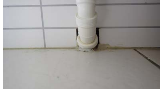
Utettheter ved rørgjennomføringer i vegg ved dusjkabinett.
