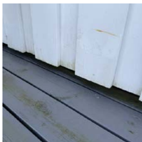
Liten avstand til terrasse og noe sprekker i bunn av kledning.
