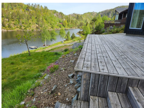
Bildet viser manglende rekkverk
