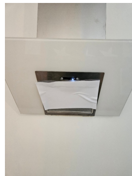
Bildet viser god avtrekk ved papirtest
