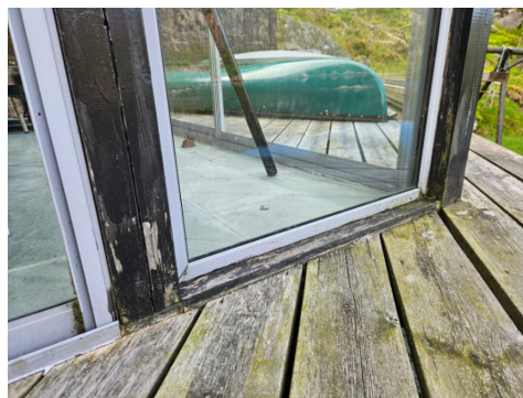
Bildet viser kontraksjon i trevirke med behov for vedlikehold/utbedring.
