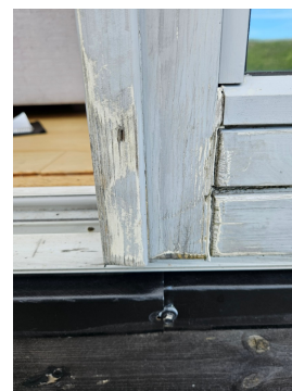
Terrassedøren har skade i nedre del
