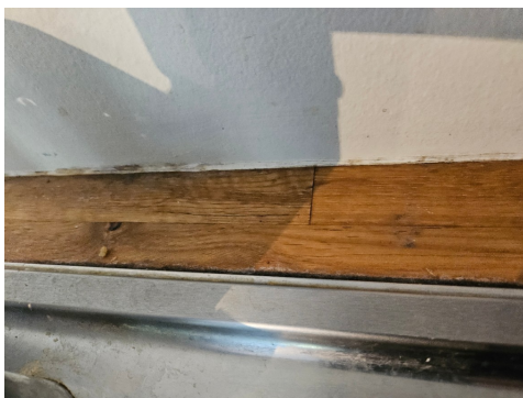
Det er observert bruksslitasje bak vask
