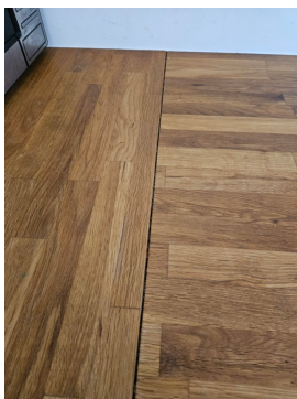
Skjøten i benkeplatene kan med fordel fuges
