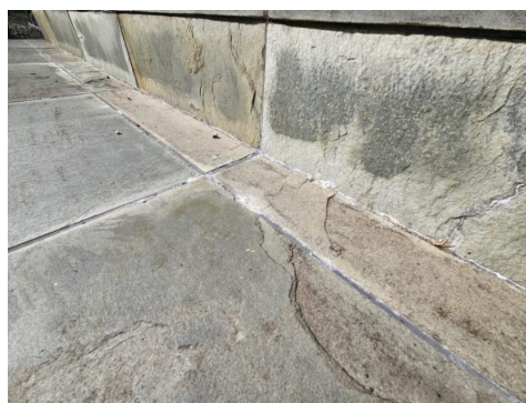
Bildet viser kalkutslag.
