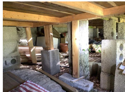
Enkel utføresle. Utbedring må gjøres.
