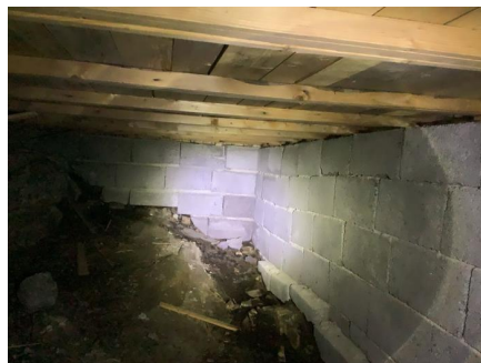
Skjevheter i grunnmur.
