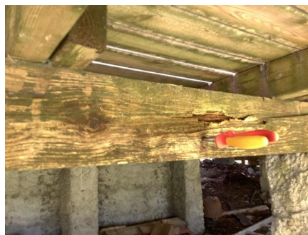
Råteskader i bæring.
