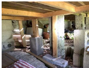
Enkel utføresle. Utbedring må gjøres.
