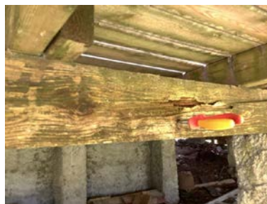
Råteskader i bæring.
