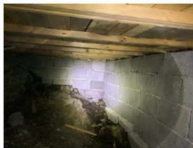
Skjevheter i grunnmur.
