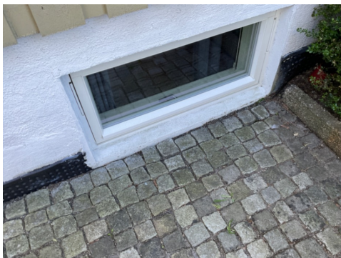
Knotteplast synlig ved kjellervindu
