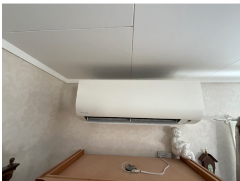
Varmepumpe i stuen
