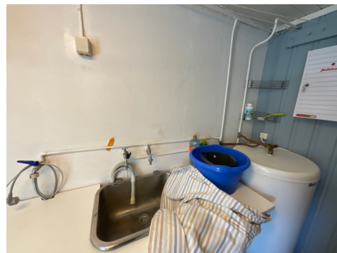
Kobberrør i vaskerommet
