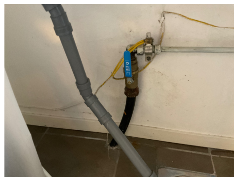
Hovedstoppekran på vaskerom
