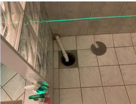
Sluk på baderom i kjelleren
