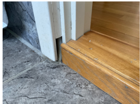
Eikelist og el-rør ved døren
