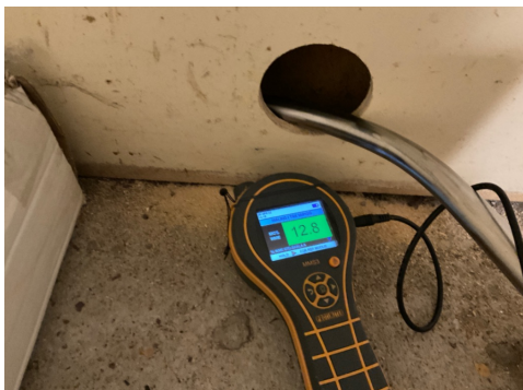
Fuktmåling i bod på yttervegg 30.04.202
