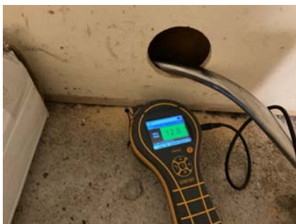
Fuktmåling i bod på yttervegg 30.04.202
