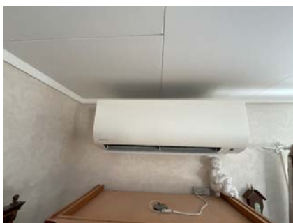
Varmepumpe i stuen
