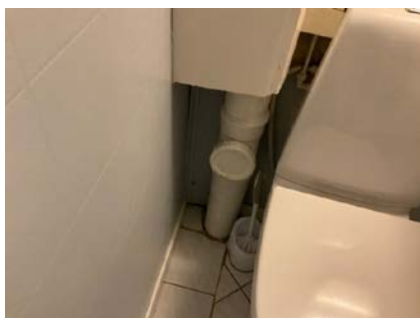
Avløpsrør på badetrom i kjelleren
