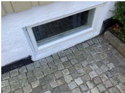
Knotteplast synlig ved kjellervindu
