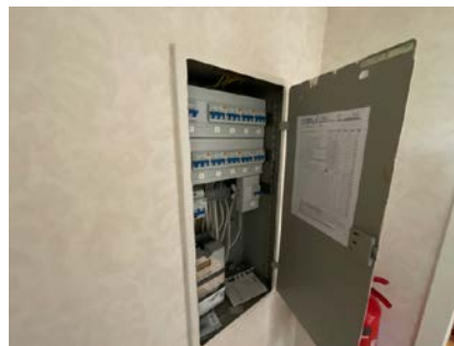
Sikringskapp i gangen
