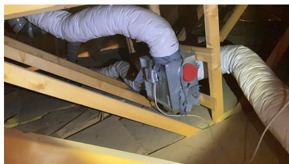
Aggregat plassert på loft.
