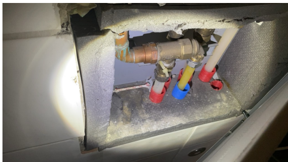
Rørskap plassert på vaskerom.
