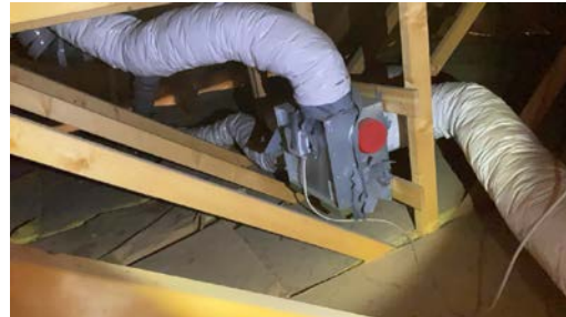
Aggregat plassert på loft.
