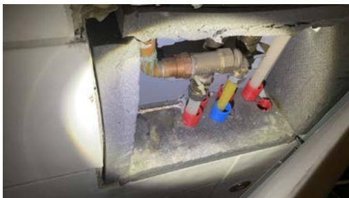
Rørskap plassert på vaskerom.
