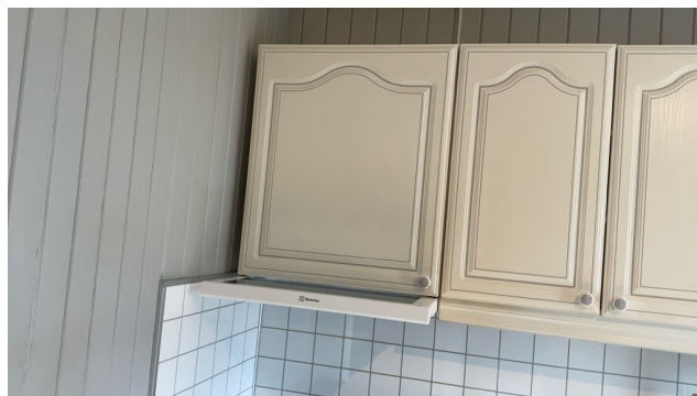
Kjøkkenventilator med avtrekk ut.
