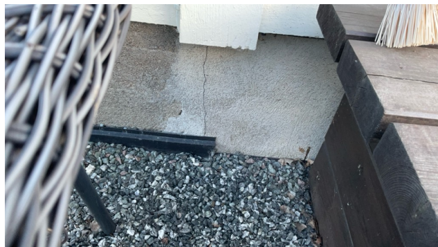
Sprekkdannelser i grunnmur/puss.
