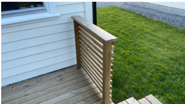
Rekkverk bør festes.
