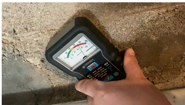
Fuktindikator gir utslag på fukt på betongvegger under terreng.
