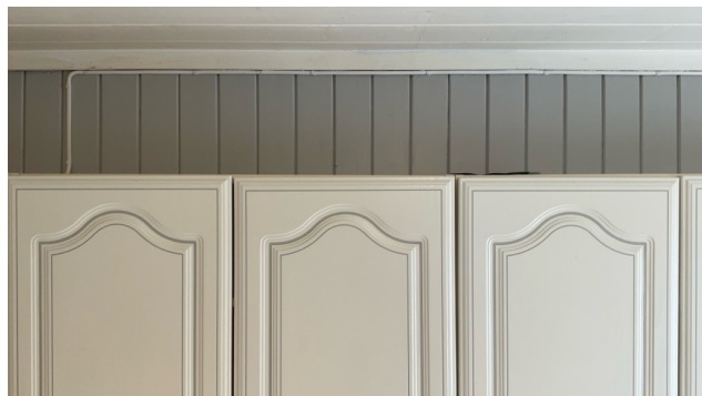
Små høydeforskjeller på kjøkkendører. Bør justeres noe.
