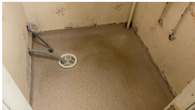
Våtrom må totalrenoveres.
