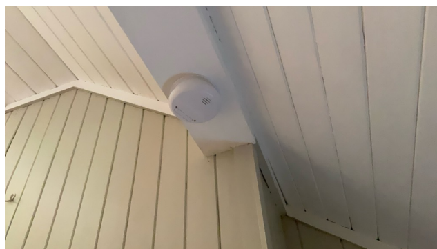
Røykvarsler i 2 etasje.
