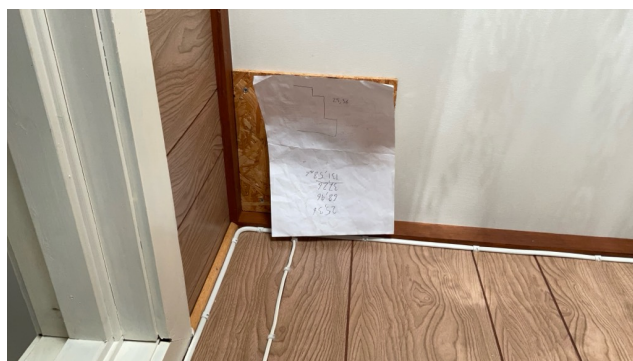
Ark henger på avtrekksventil.
