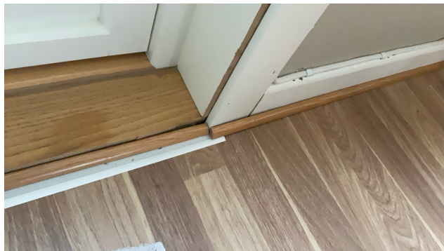
Ufagmessig utførelse på listing/gulvlegging.
