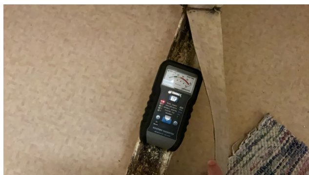
Fuktindikator gir utslag på fukt på våtrom.
