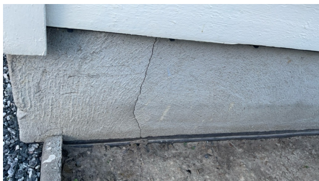
Sprekkdannelser i grunnmur/puss
