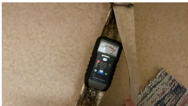
Fuktskader på våtrom.
