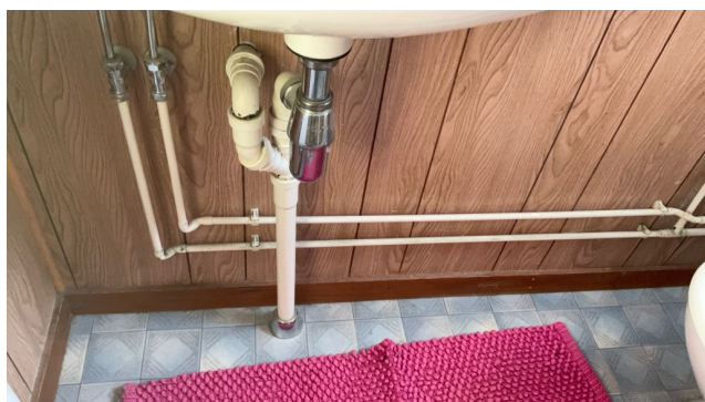
Vannledninger av kobber.
