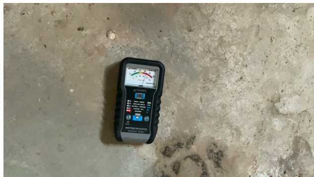
Fuktindikator gir utslag på fukt i betonggulv.
