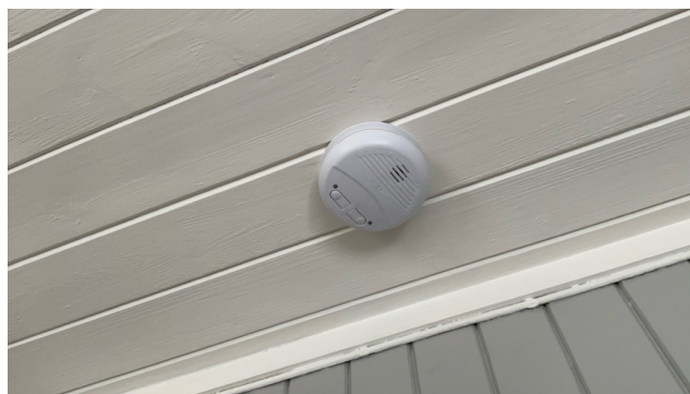
Røykvarsler i 1 etasje.
