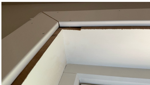
Ufagmessig utførelse på listing og skjæring av utføring.
