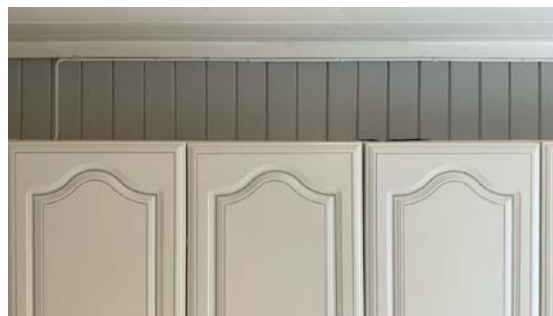
Små høydeforskjeller på kjøkkendører. Bør justeres noe.
