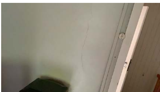
Sprekk i pipe.
