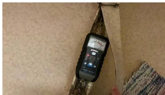
Fuktindikator gir utslag på fukt på våtrom.
