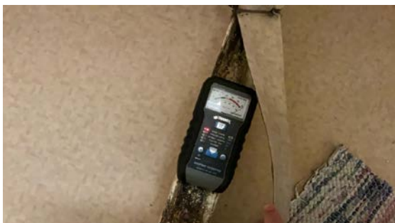
Fuktskader på våtrom.
