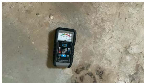
Fuktindikator gir utslag på fukt i betonggulv.
