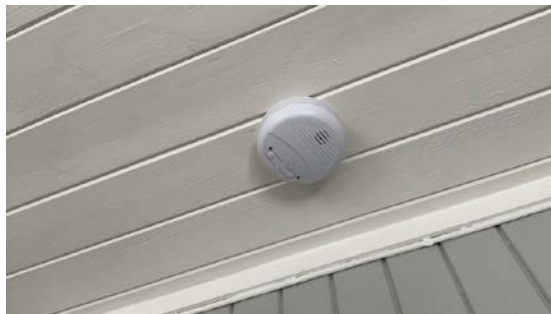
Røykvarsler i 1 etasje.
