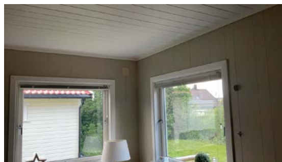
Ventiler i vegg.
