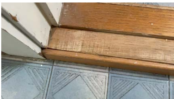
Dørblad tar i terskel ved åpning/lukking.
