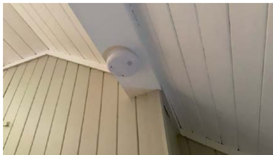
Røykvarsler i 2 etasje.
