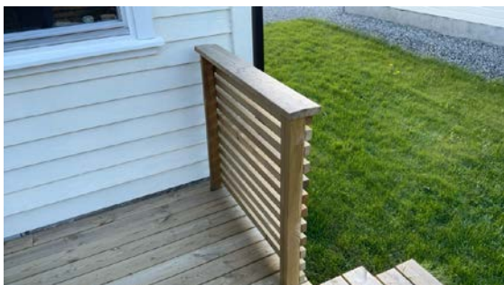
Rekkverk bør festes.
