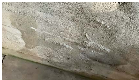
Saltutslag på betongvegg i kjeller.
