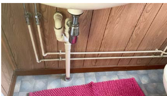
Vannledninger av kobber.
