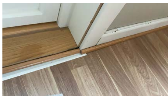
Ufagmessig utførelse på listing/gulvlegging.
