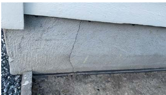
Sprekkdannelser i grunnmur/puss
