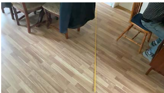
Meterstokk viser hvor avvik er registrert.
