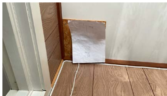
Ark henger på avtrekksventil.
