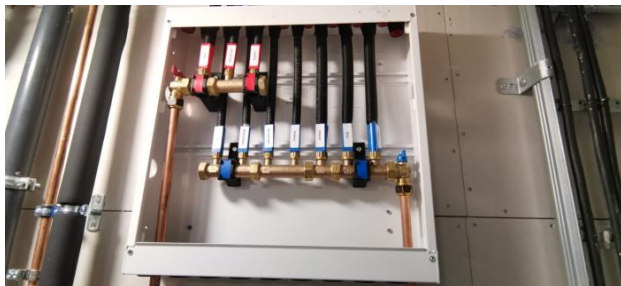
Kontroll av fordelerskap.
