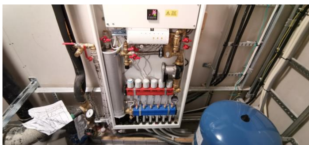
Fordelerskap plassert i teknisk rom.
