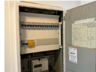
Automatsikringer i sikringsskap plassert i entre. Varmekabler i bad.
