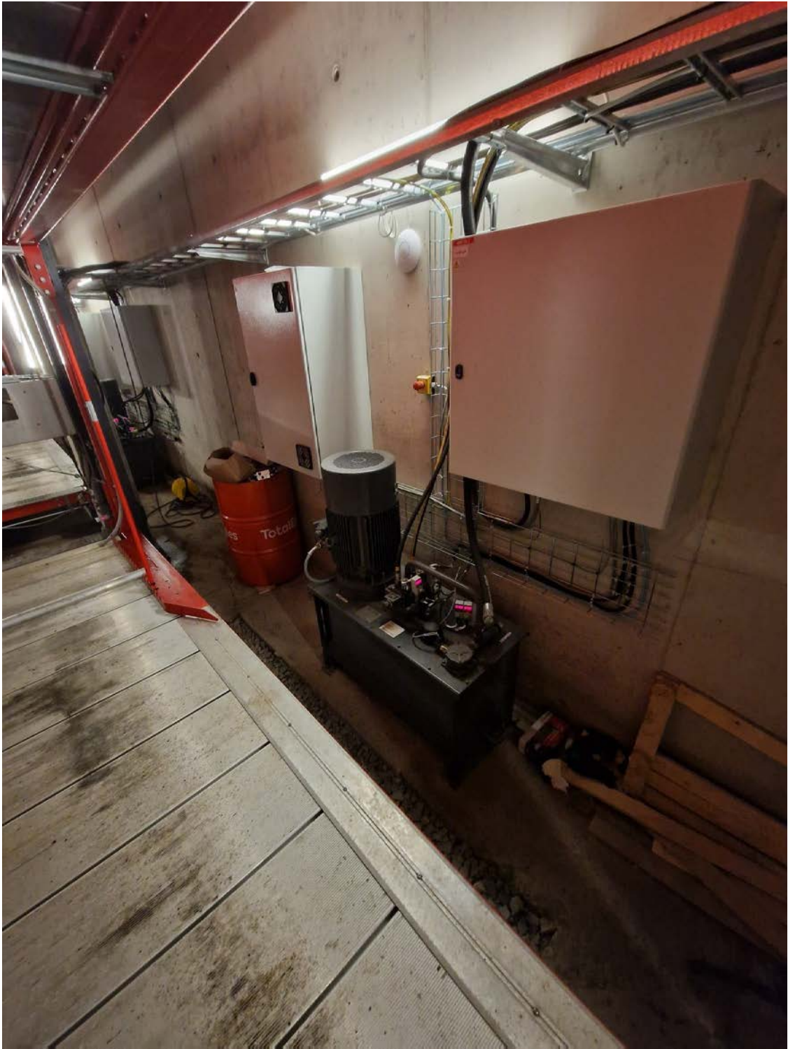
Foto 53: Maskinrom inne i parkeringsanlegg
