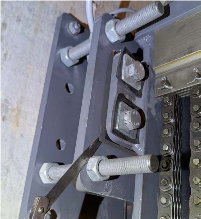
Foto 18: Klaring mellom braketter (1mm), BK1 vegg
