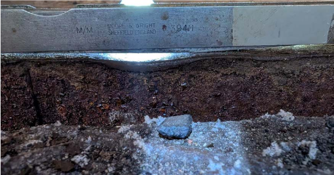
Foto 46: Lokal deformasjon over bolte hull til skinne
