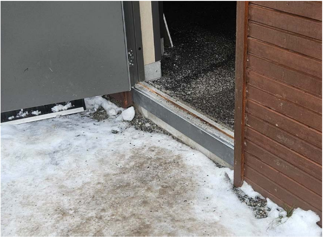
Foto 2: Persondør inn til parkeringsanlegg BK1. 18 cm høy terskel
