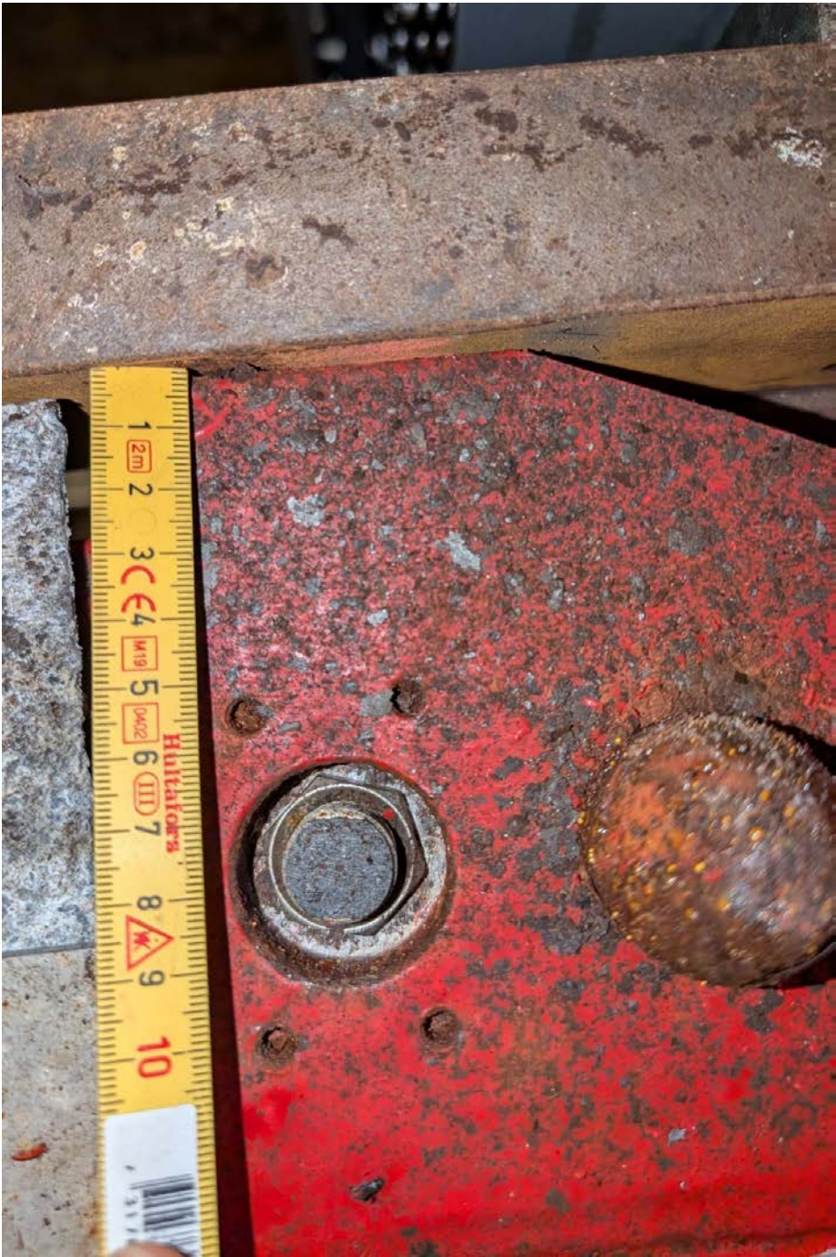
Foto 43: Liten klaring mellom plattform og skinne
