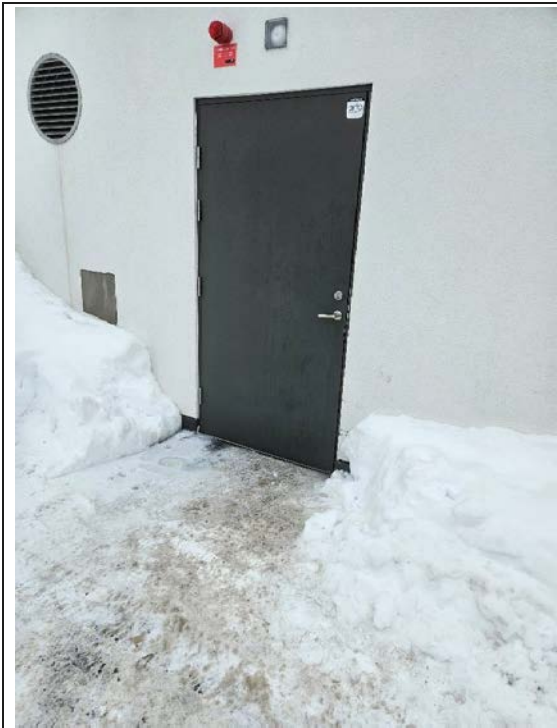
Foto 55: Dør til P2 - lav terskel, snø, is
