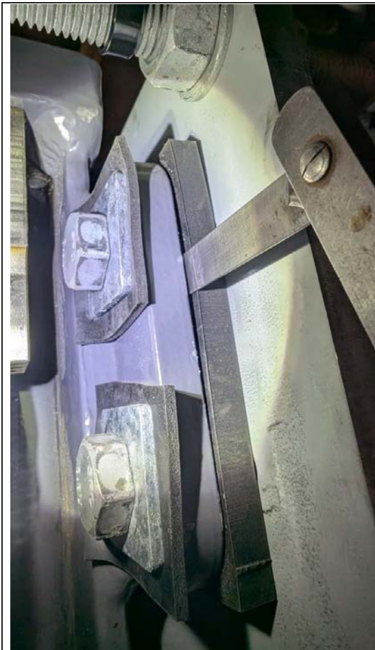
Foto 20: Klaring mellom braketter søyle, BK2
