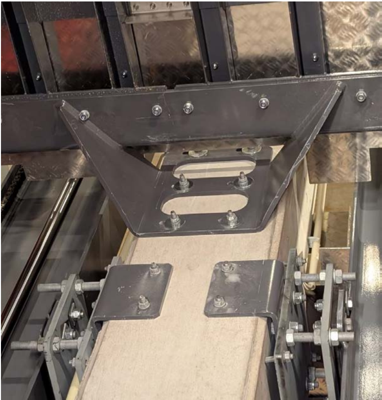
Foto 24: Kjøreplattform øvre nivå mellom rad A og B, boltet til søyle sett fra undersiden
