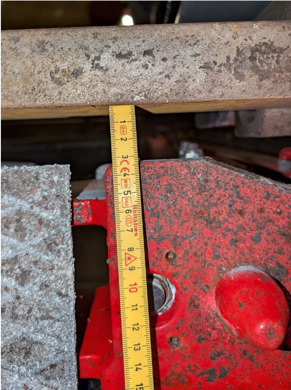
Foto 44: God klaring mellom plattform og skinne
