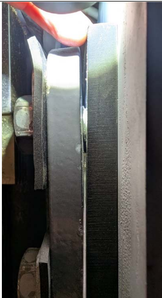
Foto 21: Klaring mellom braketter søyle, BK2
