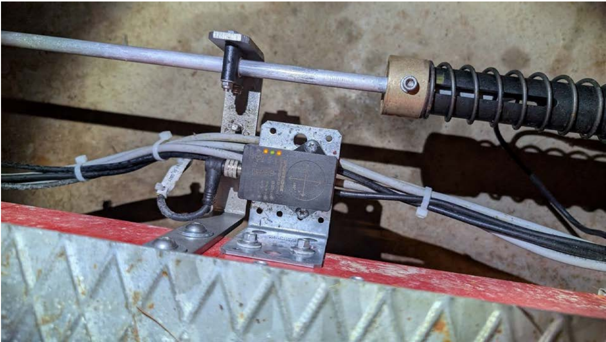
Foto 41: Vibrasjons-/temperaturmåler på plattform lokalisert ved aktuator for låsebolter
