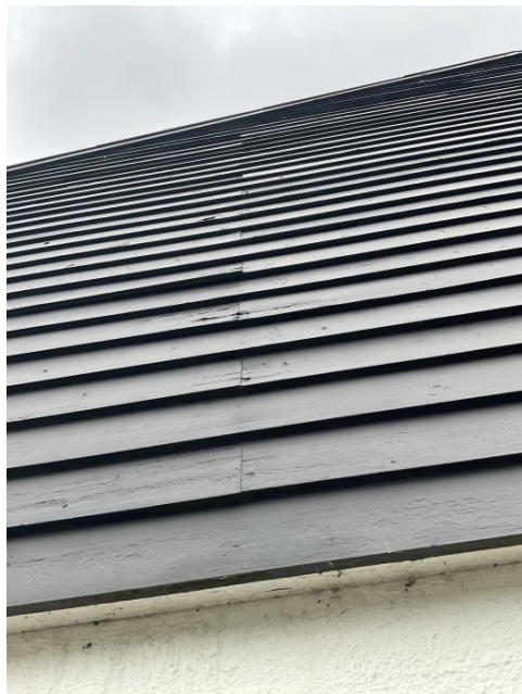
Fukt, sprekker i skjøtet kledning, ingen synlig luftning i underkant kledning.
