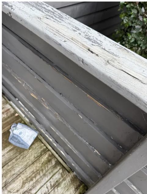
Blæring i maling, nedbrytning i trevirke terrasse og rekkverk.
