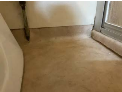
Utette overganger i skjøtet vinylbelegg.
