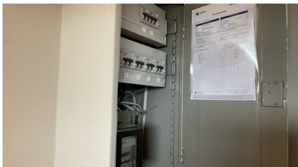
Skap i 2. etg plassert i gang.
