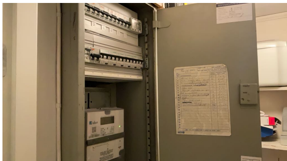
Skap i 1. etg. plassert i bod.
