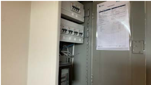
Skap i 2. etg plassert i gang.
