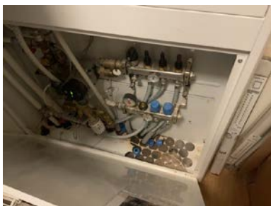
Fordelerskap for vannboren varme plassert på bod.
