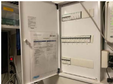
Sikringsskap plassert på bod.
