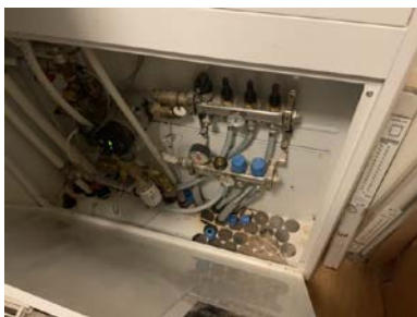
Fordelerskap for vannboren varme plassert på bod.
