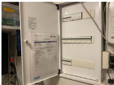
Sikringsskap plassert på bod.
