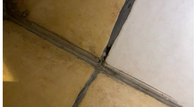
Eksempel på at flisfuger mangler.
