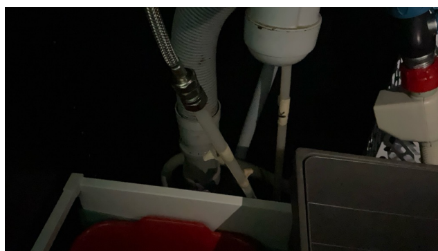
Vannledninger av plast
