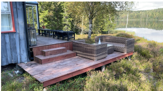
Eksempel på at rekkverk mangler.
