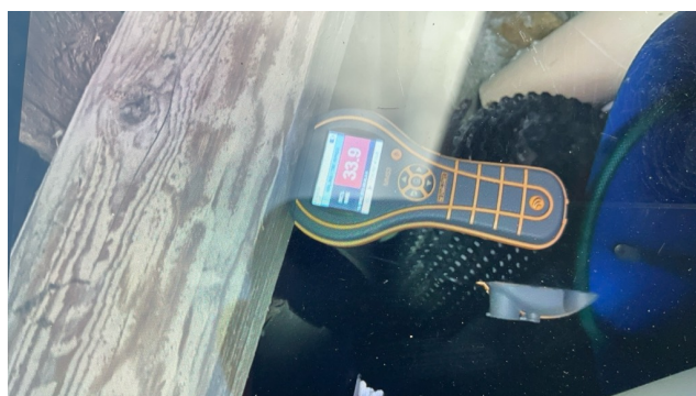
Fuktmåling i treverk med pigger gir utslag på fukt i trebjelke(r).
