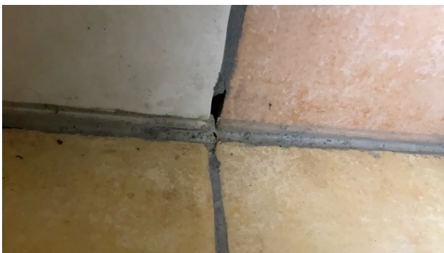
Eksempel på at flisfuger mangler.
