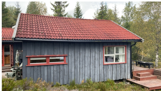
Eksempel på unormale skjevheter på takrenne. Snøfangere ikke montert.
