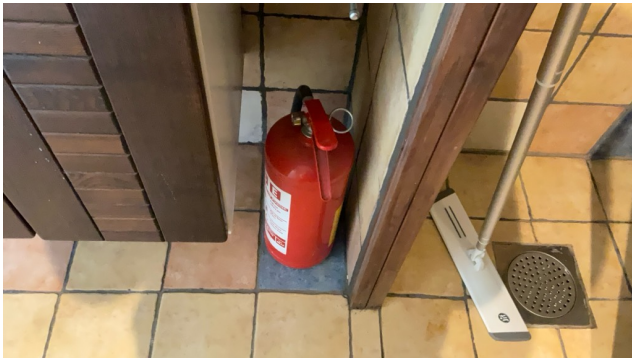
Brannslukningsapparat eldre enn 10 år.
