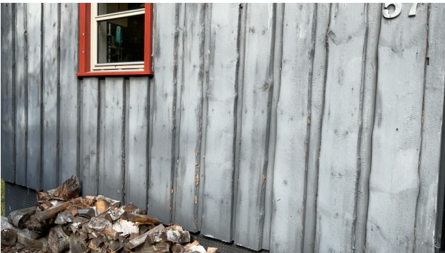
Eksempel på at bordkledning har manglende vedlikehold.
