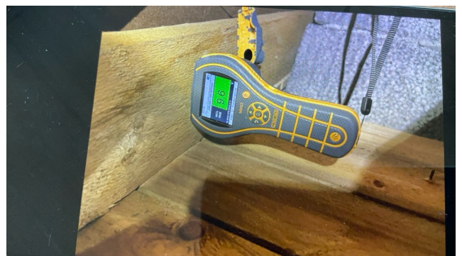
Fuktmåling med pigger i fuktskjolde uten unormale resultater. Symptom på eldre fuktskjolde.
