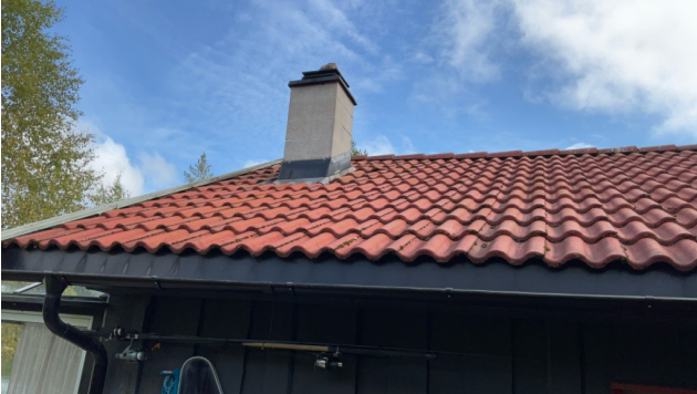
Stigetrinn og plattform til feier mangler.
