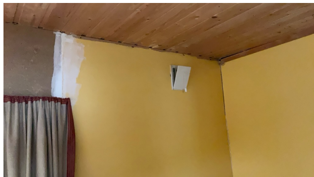
Eksempel på gjenstående arbeider.
