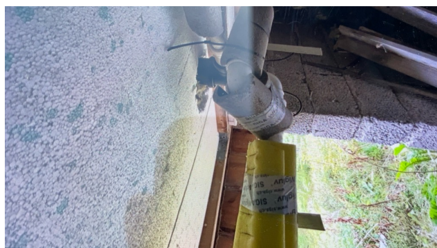
Ufagmessig isolering av avløpsrør.
