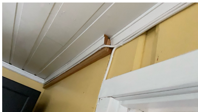
Eksempel på ufagmessig utførelse.
