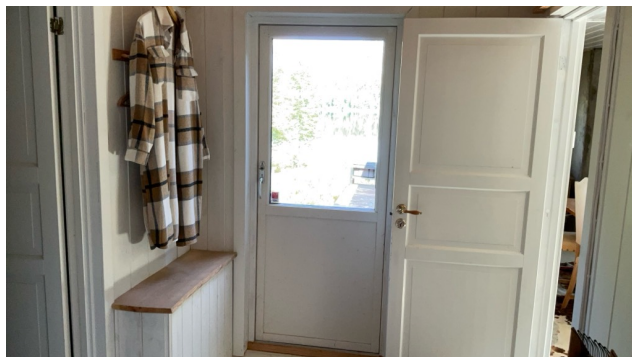
Terrassedør tar i terskel ved åpning/lukking.
