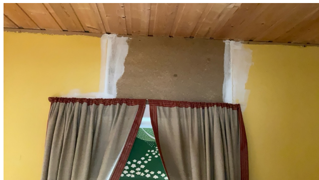
Eksempel på gjenstående arbeider.
