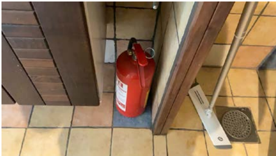
Brannslukningsapparat eldre enn 10 år.
