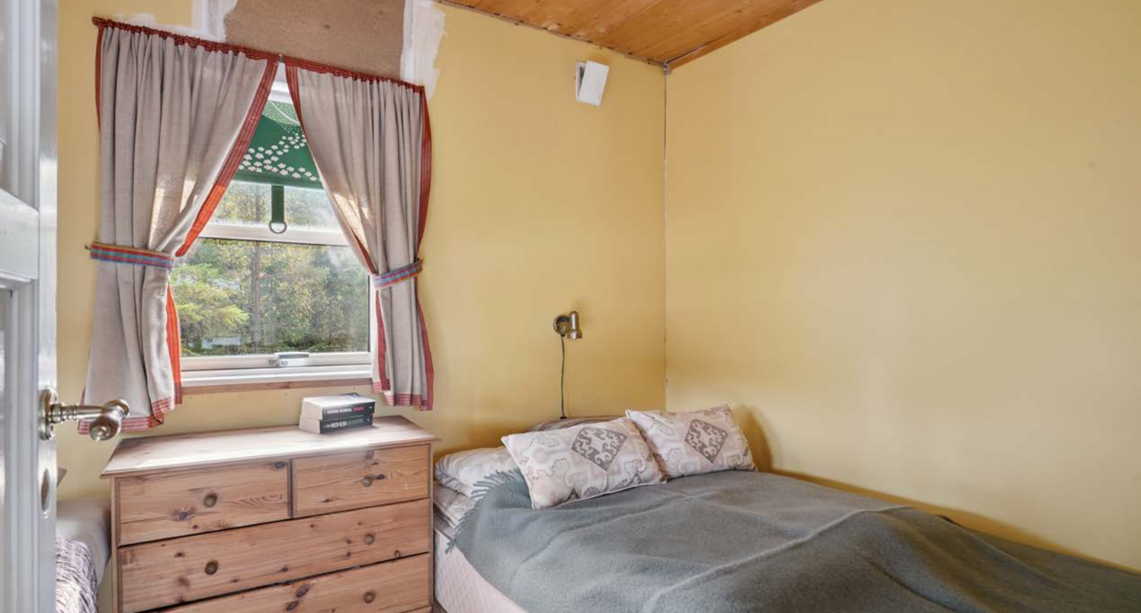
Soverom 2. Det er noe uferdige arbeider på dette soverommet.
