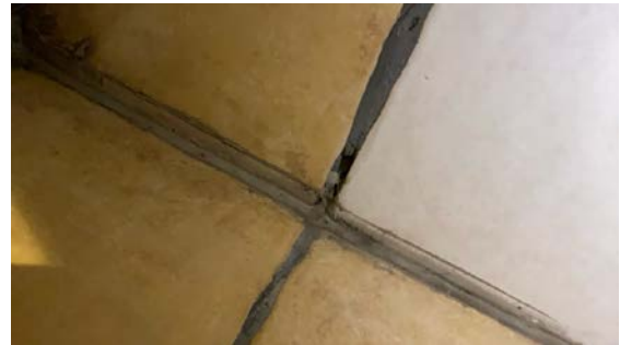
Eksempel på at flisfuger mangler.
