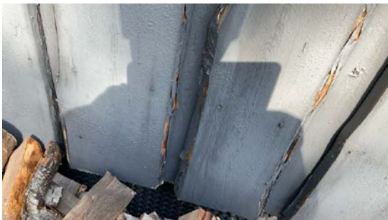
Eksempel på at bordkledning har manglende vedlikehold.
