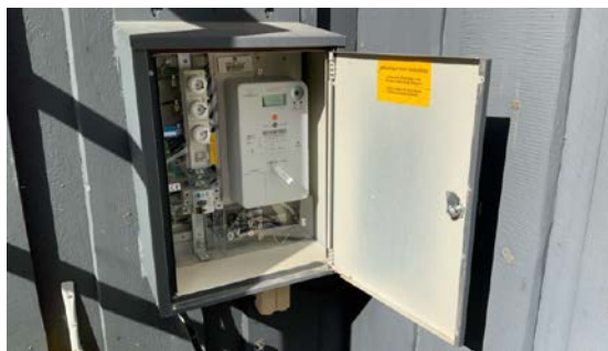
Sikringsskap uten kursfortegnelse.
