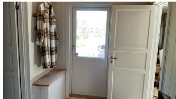
Terrassedør tar i terskel ved åpning/lukking.
