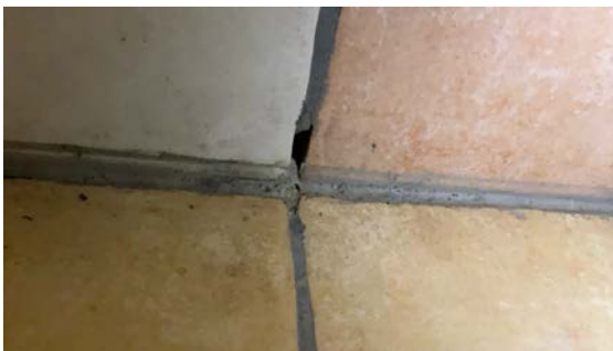
Eksempel på at flisfuger mangler.
