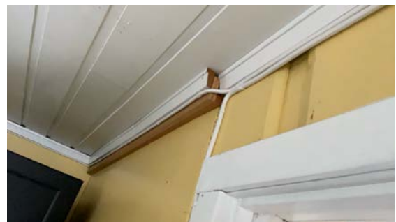
Eksempel på ufagmessig utførelse.
