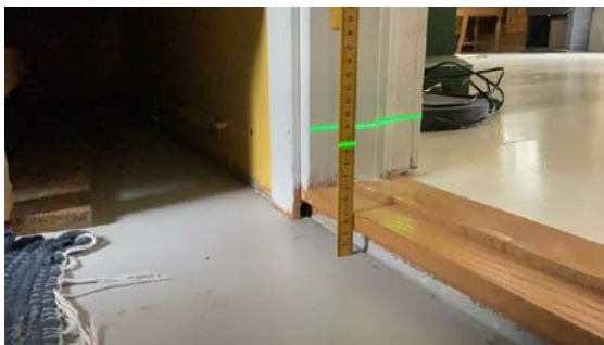
Det er målt 9,8cm ved utgangspunkt ved terskel.
