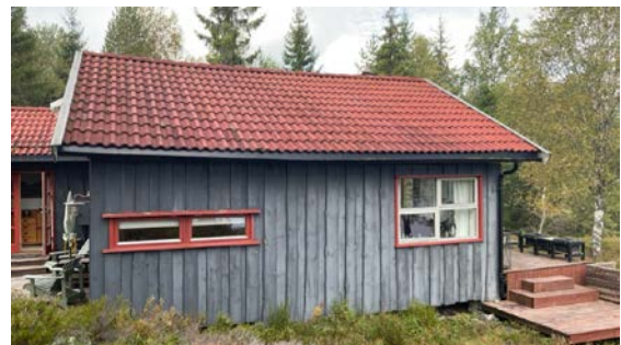
Eksempel på unormale skjevheter på takrenne. Snøfangere ikke montert.
