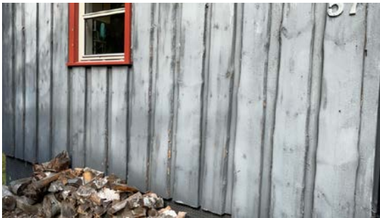
Eksempel på at bordkledning har manglende vedlikehold.
