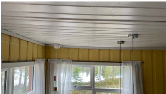
Eksempel på store skjevheter i himling ved måling med laser.
