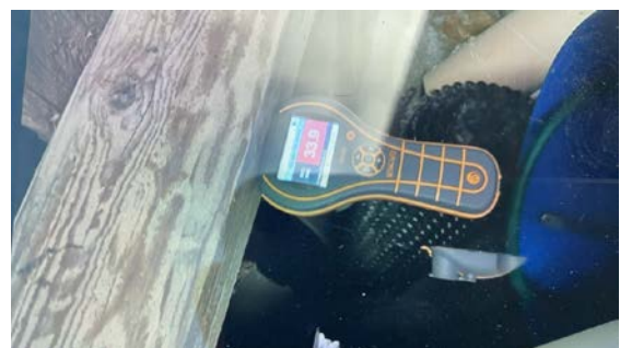
Fuktmåling i treverk med pigger gir utslag på fukt i trebjelke(r). !
