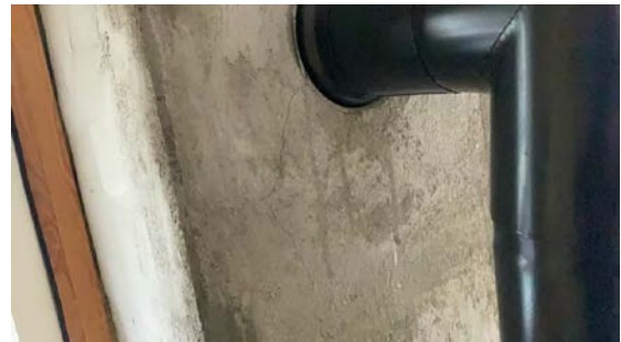
Eksempel på riss/sprekk i pipe.
