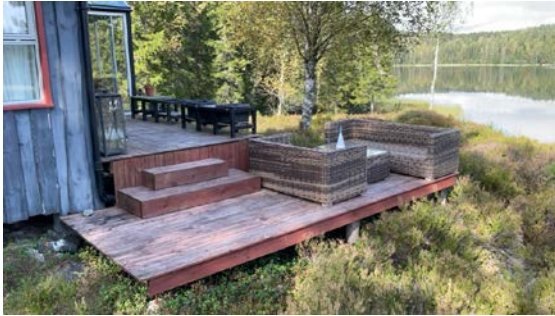
Eksempel på at rekkverk mangler.
