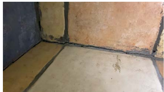
Sprekk i overgang gulv/vegg.
