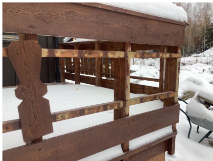
Eksempel på kledningsbord som er fjernet fra rekkverk.
