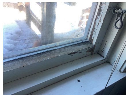
Eksempel på slitasje.
