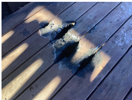
Brannskade på gulv ved entre.
