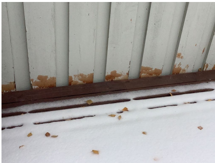
Malingsøl på vegger ved veranda.
