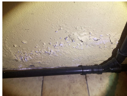
Saltutslag og avskaling på vegger
