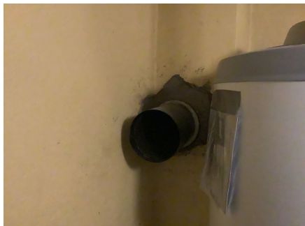
Åpent røykrør på vaskerom.
