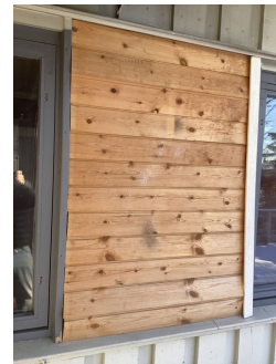
Ubehandlet kledning mellom vinduer, løsner delvis fra innfesting.
