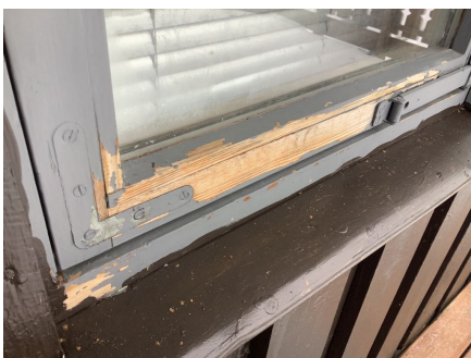
Eksempel på slitasje.
