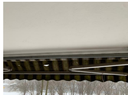
Markise i dårlig forfatning
