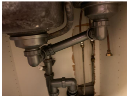
Rørapplegget i kjøkkenet
