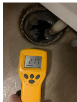
Noe for høye fuktsøkverdier rundt/ ved sluk
