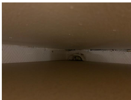
Ventil tildels tildekket. Bør frigjøres
