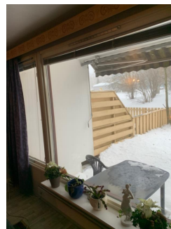
Vinduer fra byggeår. Punktert glass
