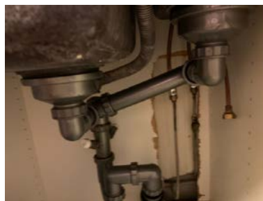
Rørplegget i kjøkkenet
