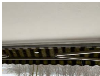
Markise i dårlig forfatning
