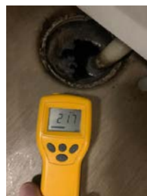
Noe for høye fuktsøkverdier rundt/ ved sluk
