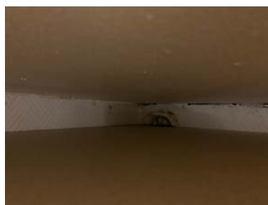
Ventil tildels tildekket. Bør frigjøres
