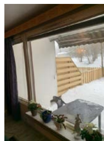
Vinduer fra byggeår. Punktert glass
