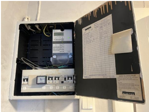
Sikringskap plassert i entre.
