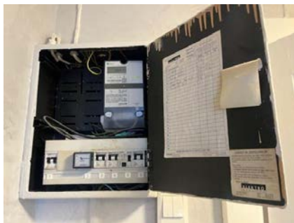
Sikringskap plassert i entre.
