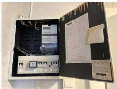
Sikringskap plassert i entre.
