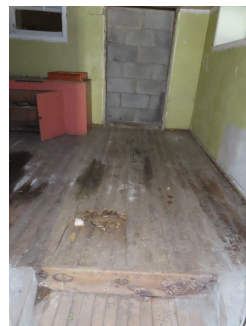
Råteskader i oppforet tilfarergulv.
