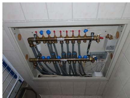
Samleskap for vannbårent varmesystem.
