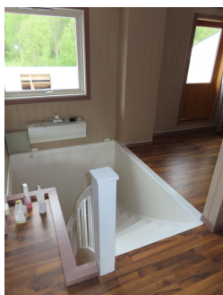
Trappe mellom 1 og 2.etg. Det mangler rekkverk og håndløper.
