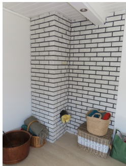
Ikke tilfredsstillende sikring av rørrinnføring.
