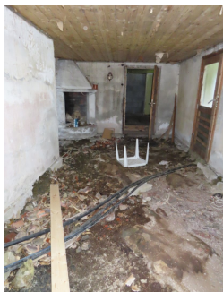
Del av kjeller. Kjellergulv er brutt opp. Det ses fukt/saltutslag i vegger.
