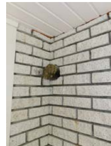
Ikke tilfredsstillende sikring av rørrinnføring.
