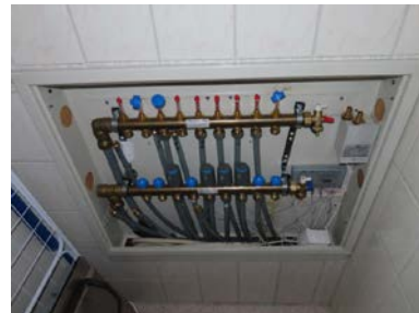
Samleskap for vannbårent varmesystem.
