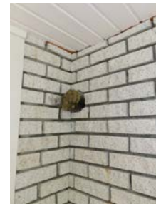
Ikke tilfredsstillende sikring av r rinnf ring.
