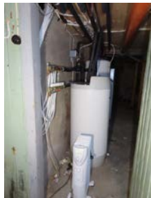
Kjellerplan med varmtvannsberedere samt åpent installert rørsystem for vannbåren varme.
