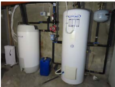
2 stk varmtvannsberedere - en for tappevannet og en dobbelmantlet for bla varmeanlegget.
