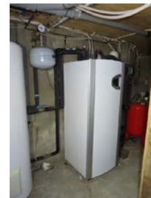
Vann til væske varmepumpe som leverandør av oppvarmet vann til vannbårent varmeanlegg i bygget.
