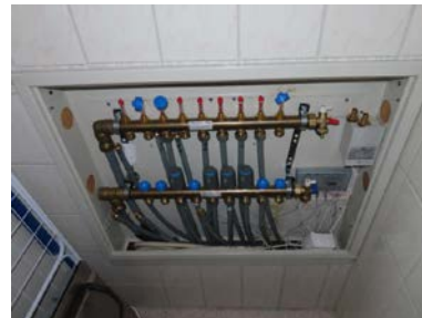
Samleskap for vannbårent varmesystem.
