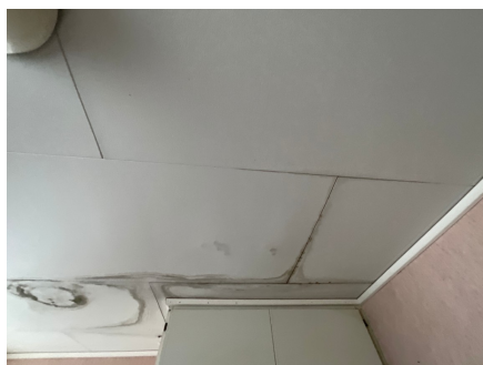
Fuktmerker rundt luftpipe i 2. etasje.
