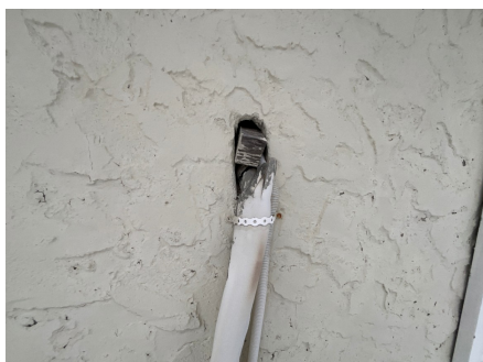
Ikke tilstrekkelig tett hull i murveggen.
