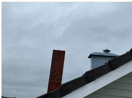
Mangler topp på pipen.
