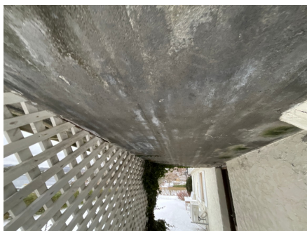
Noe løs betong på undersiden.
