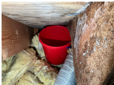
Lekkasjer rundt luftelyre.
