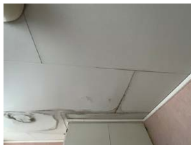
Fuktmerker rundt luftpipe i 2. etasje.
