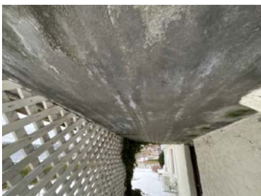
Noe løs betong på undersiden.
