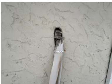
Ikke tilstrekkelig tett hull i murveggen.
