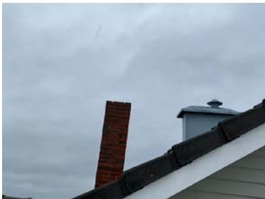
Mangler topp på pipen.
