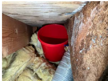
Lekkasjer rundt luftelyre.
