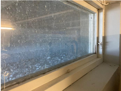
Koblet vindu med slitasje.
