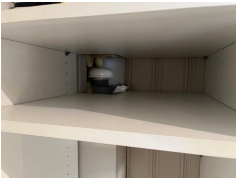
Vakumventil i garderobeskap entre hoveddel.
