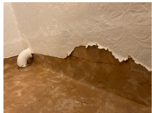
Skader på vegger.
