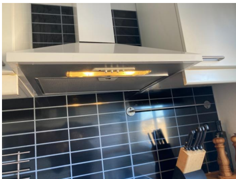
Ventilator uten kanal ut.
