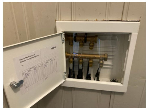
Vann fordelerskap til renovert bad i hoveddel.
