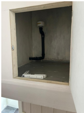
Vakumventil i trappeskott til leilighet.
