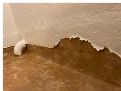
Skader på vegger.
