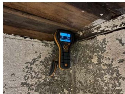
Fuktmåling i himling viste ca. 15 %, som er normalt.
