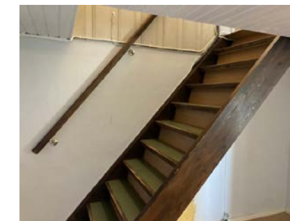
Trapp hoveddel mangler rekkverk.
