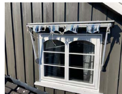
Markiseduk har skader.
