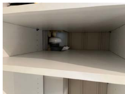
Vakumventil i garderobeskap entre hoveddel.
