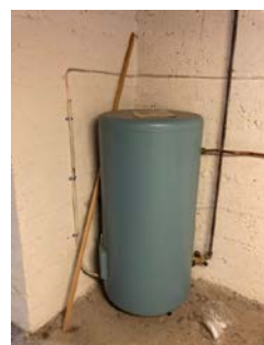
Varmtvannstank til begge boenheter.
