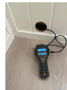
Fuktmåling i utforet yttervegg viste 12 %, som er normalt.
