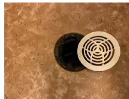
Sluk i dusjsone.
