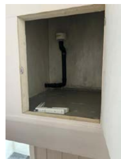
Vakumventil i trappekott til leilighet.
