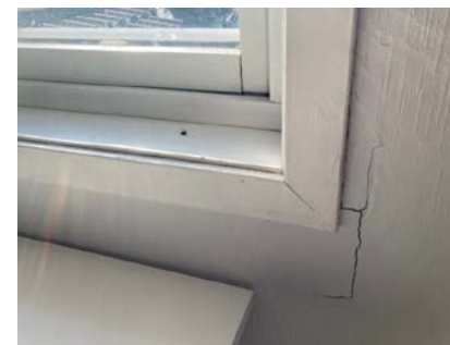
Sprekk i veggplate.
