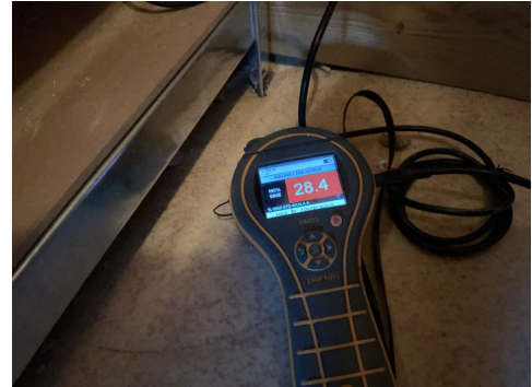
Fuktmåling i rød sone, vått. Synlige fuktmerker på veggplate i hjørne i bod.
