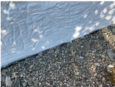
Mangler kantlist ved avslutning av knotteplast over terreng.
