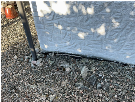
Knotteplast langs vegg mangler topplst/ kantavslutningslist.
