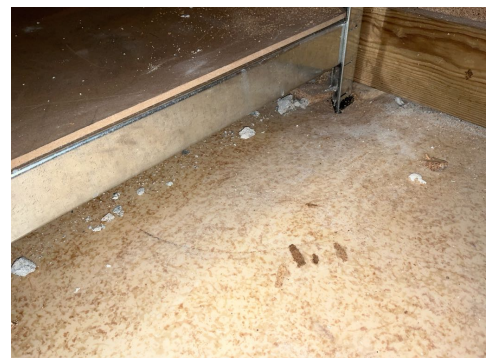
Synlig fuktskade på gulv og vegg
