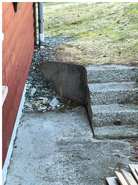
I dette området trengs det utbedring for å lede overvann bort fra byggegrøp.
