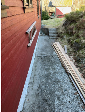
Drenering og overvann må ledes bort fra byggegrøp.
