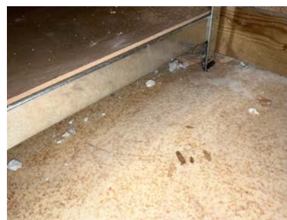
Synlig fuktskade på gulv og vegg
