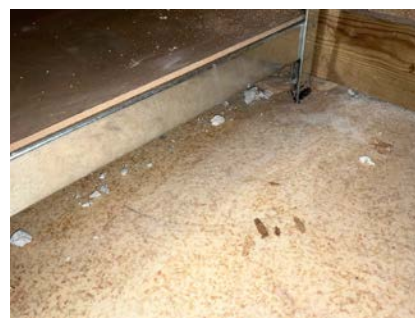
Synlig fuktskade på gulv og vegg
