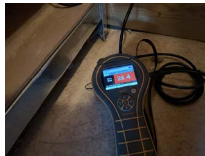
Fuktmåling i rød sone, vått. Synlige fuktmerker på veggplate i hjørne i bod.
