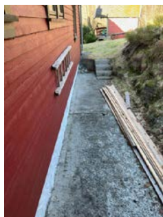
Drenering og overvann må ledes bort fra byggegrop.
