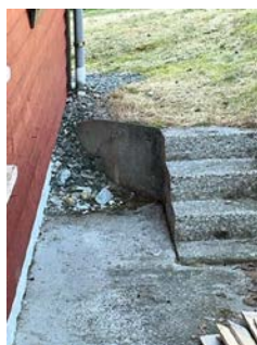
I dette området trengs det utbedring for å lede overvann bort fra byggegrop.
